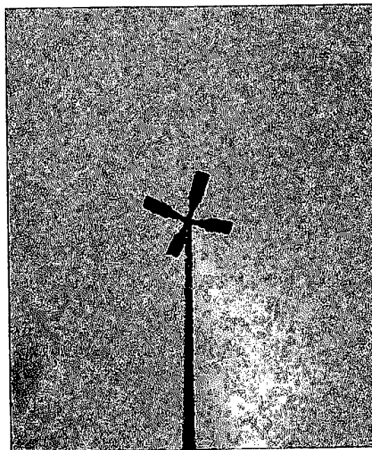
Foto 26: Poste de iluminação pública.
