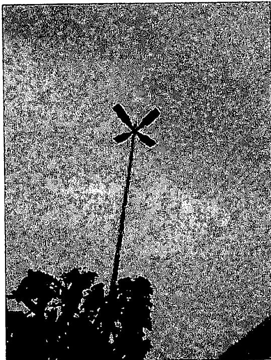
Foto 25: Poste de iluminação pública.
